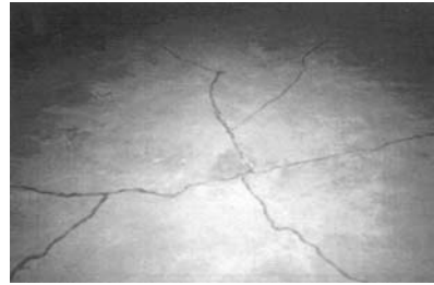
Nứt "chân chim" tập trung
